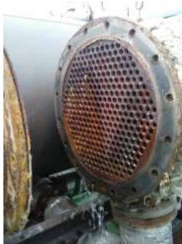
Рис. 1. Сквозная коррозия трубок
